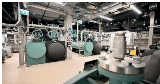
FOTO: WIEN ENERGIE
